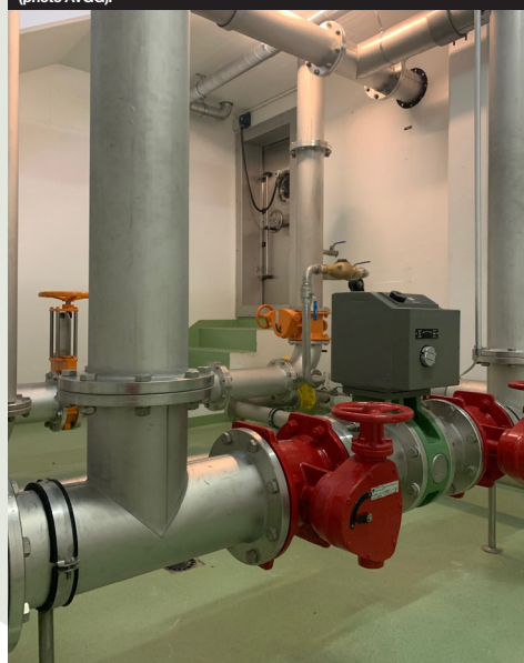
L'arrivée des eaux de l'AVGG dans le réservoir de l'Alpage de Granges (photo AVGG).
